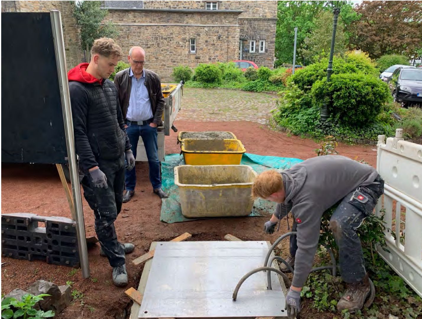
Klaus Meyer vom UnserFriedrich-Projektteam (2. v. links) verfolgt die Fundamentarbeiten von Fabian Mirsch (re.) & Timo Neuhaus (li.) von der Firma Christian Korge Bauunternehmen
